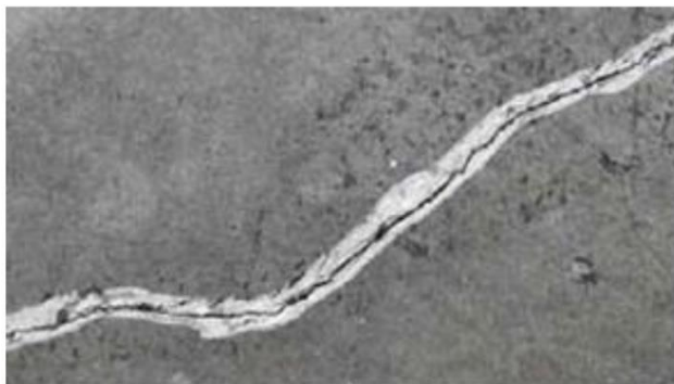
Рисунок 6. V-образная канавка вдоль трещины
